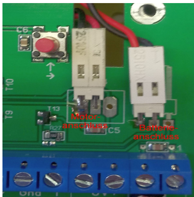
Bild 2b: Lage Batterieanschluss
